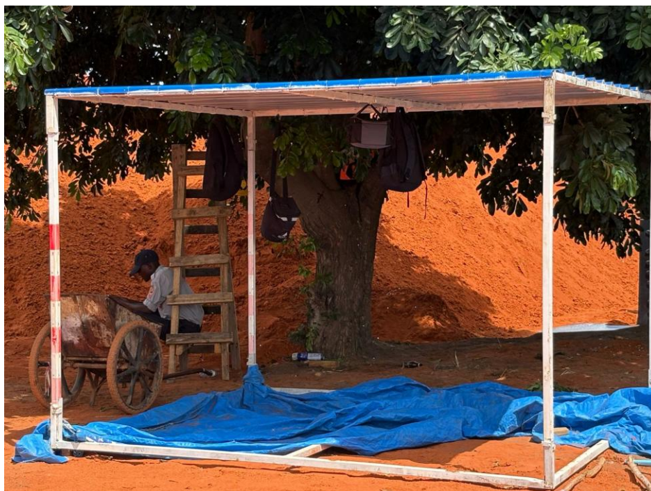
Imagem 6 - Quick Wins da Matola – zona de sombra para refeições (Traçado de Intaka-Boquisso)
