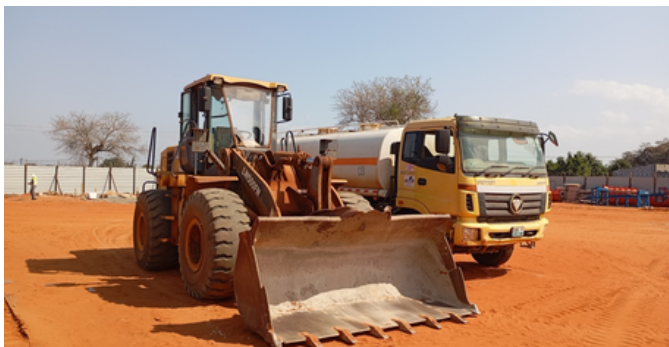
Equipamento de obras mobilizado no estaleiro central implantado pelo empreiteiro da via Mathlemele/Wamatibjwana
