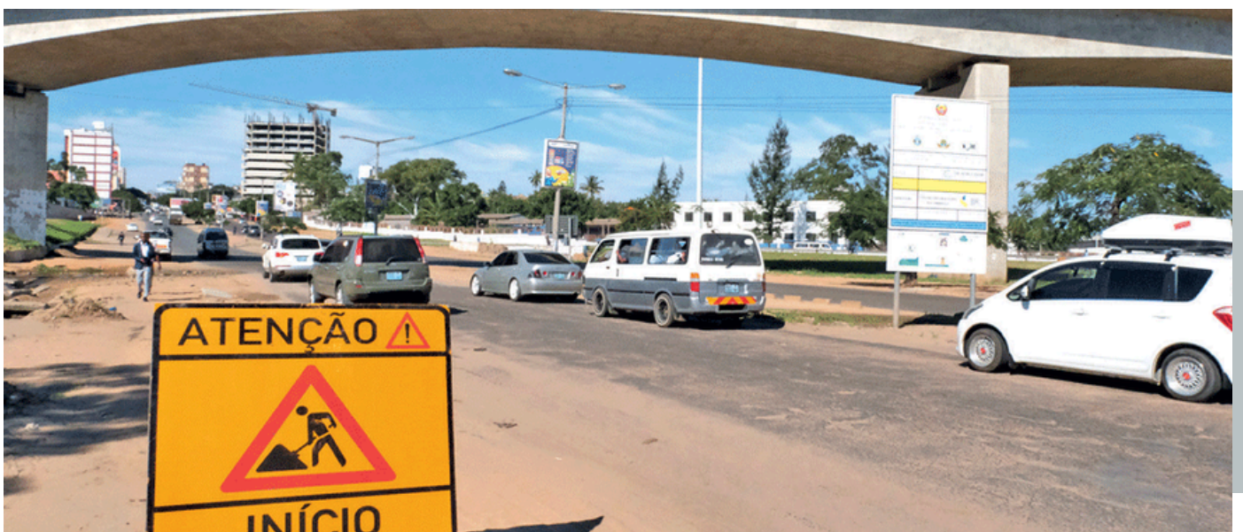
Arranque das obras de reabilitação da Avenida 24 de Julho, no Município de Maputo
